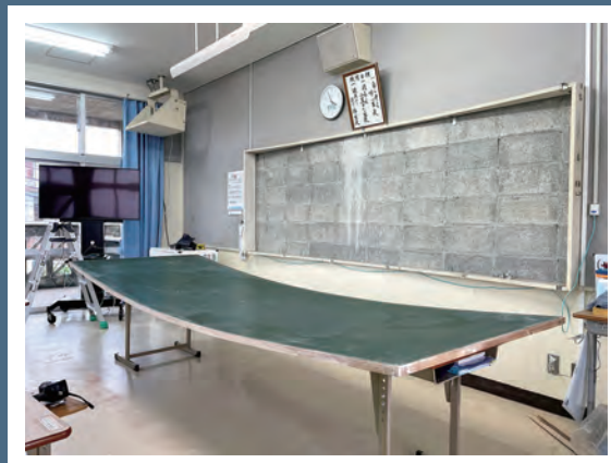
実際の施工風景 ※備品は学校側の許可を得て使用しています 作業完了後、清掃します
